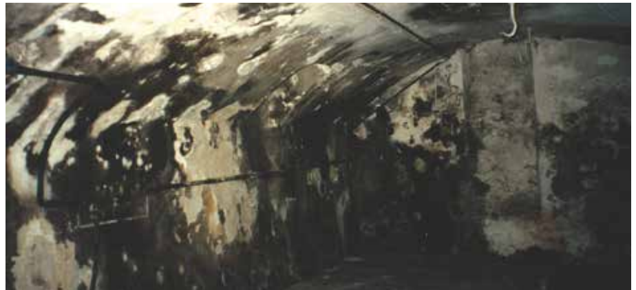
Durchnässter Gewölbekeller mit Folgeschäden an Putz, Mörtel und rohem Mauerwerk. Bild: Anderegg Mauerentfeuchtung GmbH
